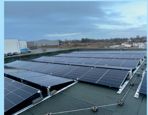
Neue Photovoltaikanlage auf dem Dach der Zentralküche in Kropp
